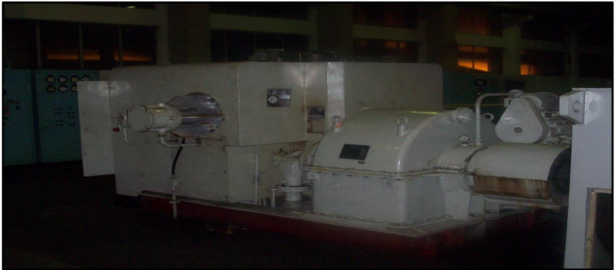
Figura 08 - Turbina a vapor
