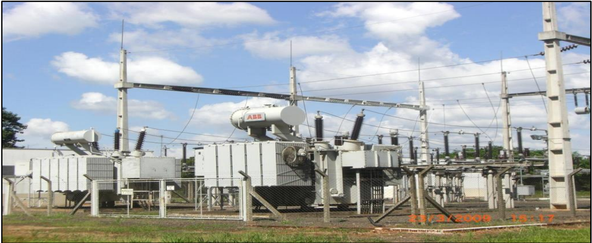
Figura 14 - Subestação de energia na usina
