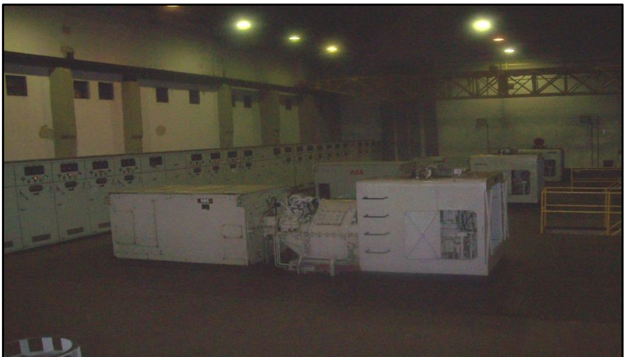
Figura 07 - Geradores de energia Fonte: Usina da Barra – Grupo Cosan
