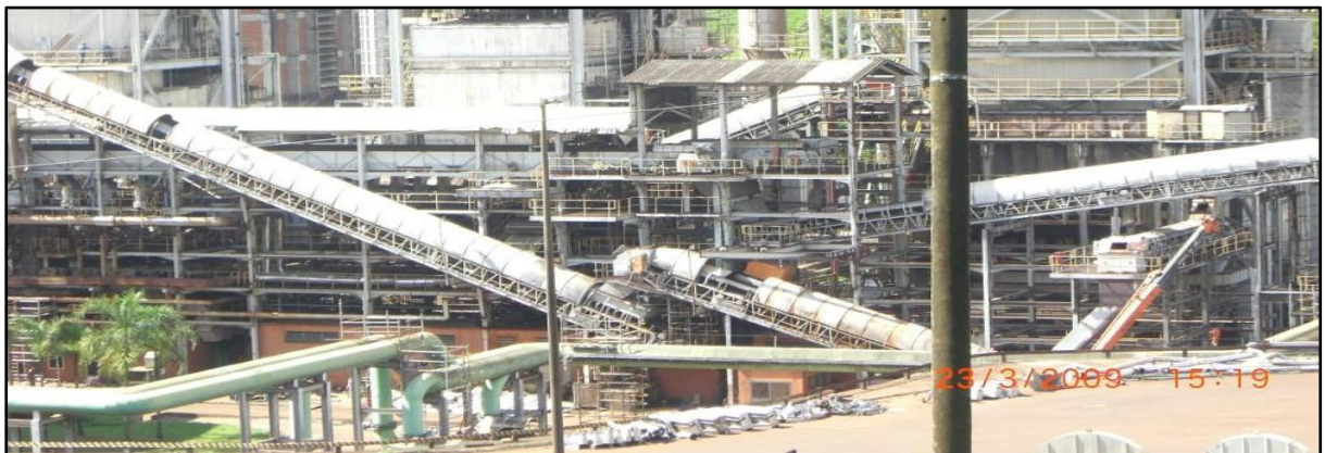
Figura 11 - Esteira transportadora de bagaço Fonte: Usina Barra Grande – Grupo Zilor
