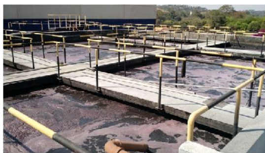
Figura 3. Tanque de Aeração do Tratamento Biológico. Fonte: Próprios Autores (2018).
