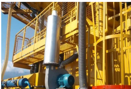
Figuras 20, 21 e 22: Silenciador instalado
