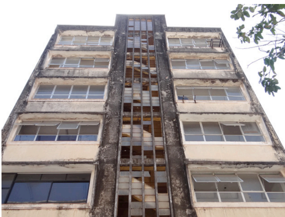
Figura 6. Edifício totalmente desocupado e degradado.
