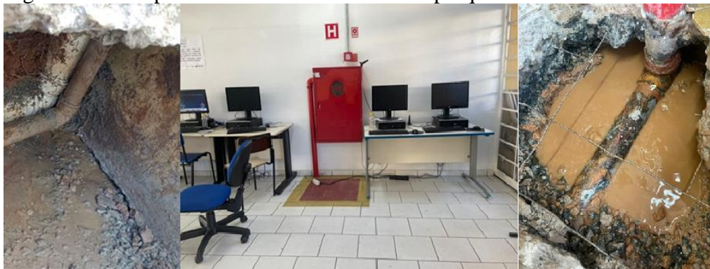
Figura 6 – Exemplo de vazamentos localizados em pesquisa interna de vazamentos.
