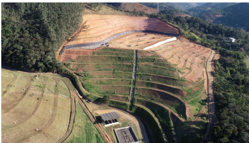
Figura 5: Área de disposição final ambientalmente adequada do CDR da EBMA. Fonte: Sítio eletrônico do empreendimento (2018)
