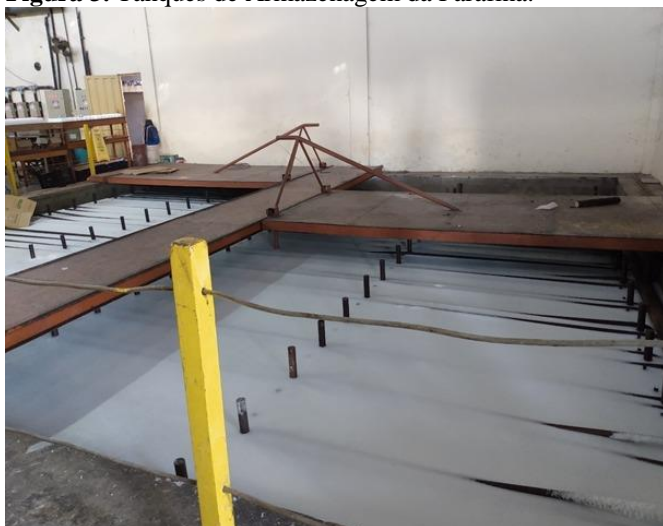
Figura 3. Tanques de Armazenagem da Parafina.
