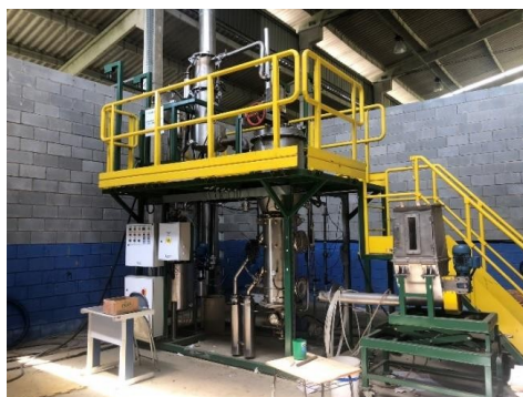
Figura 11. Equipamento incinerador. Fonte: Dados da Pesquisa.
