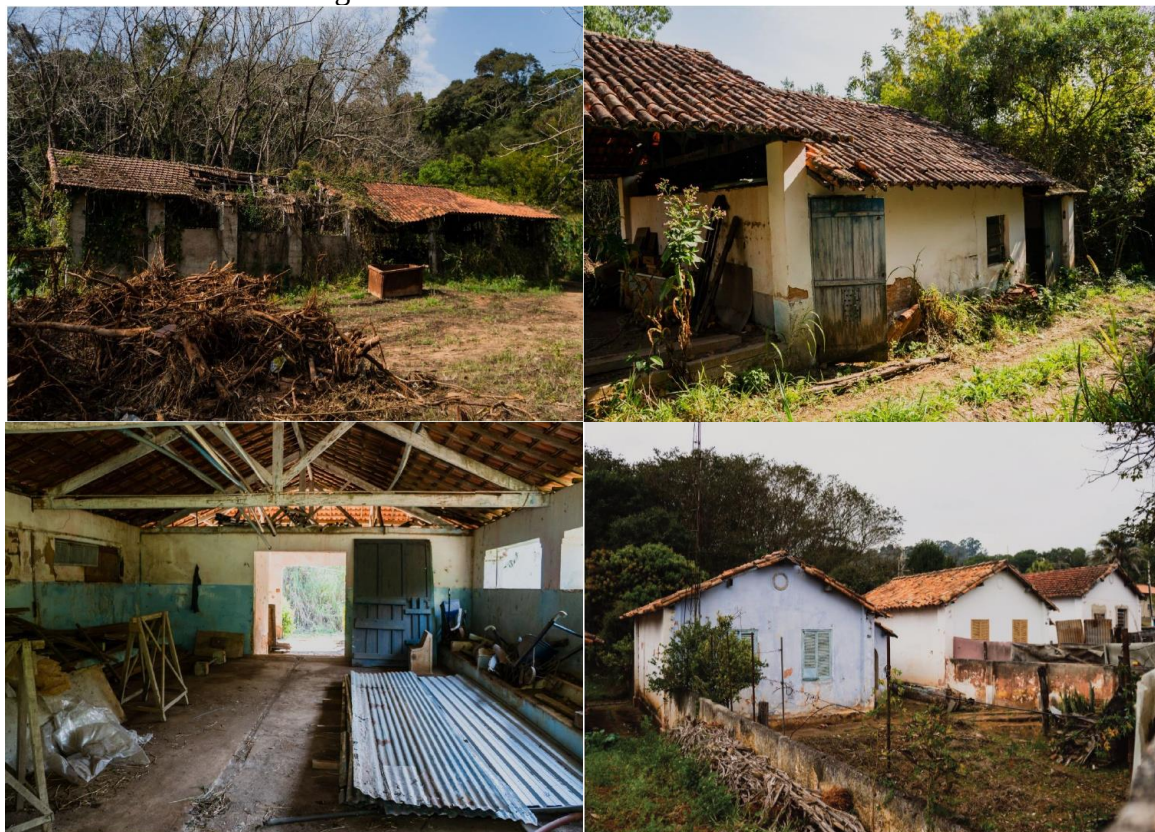
Figura 5 – Estruturas abandonadas na UPD-AE
