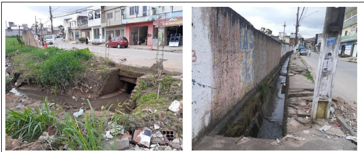
Figura 2 - Esgoto a céu aberto na avenida principal do bairro Borges
