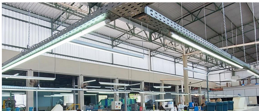
Figura 1 – Iluminação adequada de todo prédio fabril
