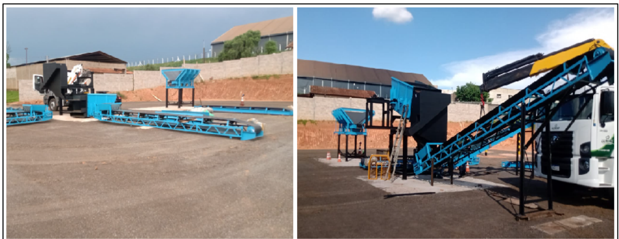
Figura 2 - Área de Execução do Projeto e Triturador Industrial Instalado
