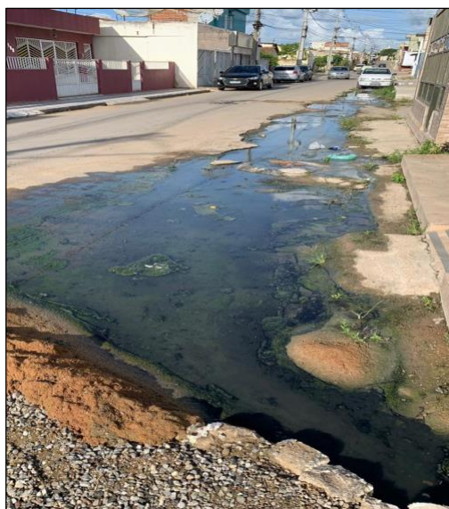
Figura 2 – Esgoto a céu aberto
